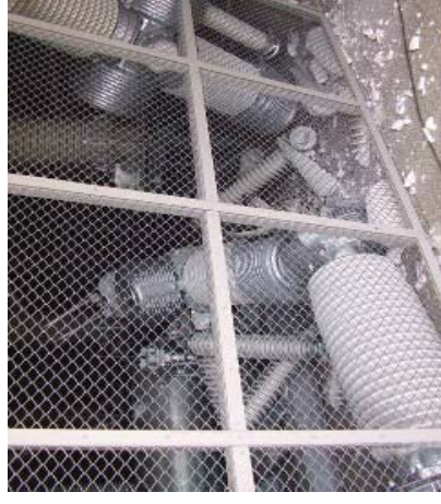
【鹿島変電所】275kV遮断器損傷
