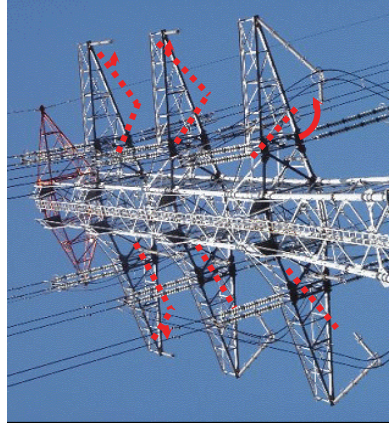
【275kV東海原子力線 No.38鉄塔】 がいに折損
